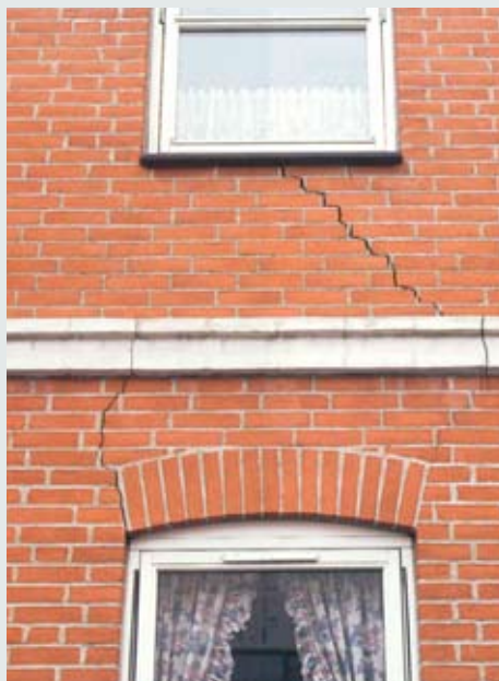
Sætningsrevner i murværk som følge af forkert beregnet pælefundering.
